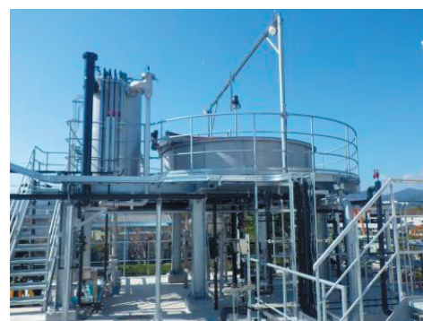
【排水処理施設】
