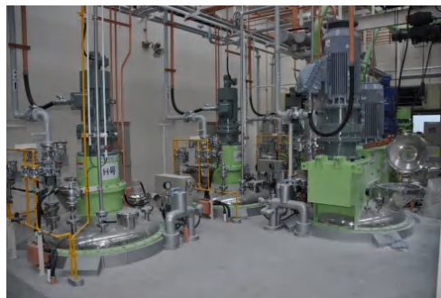
床用接着剤 ベース製造・貯蔵タンク
