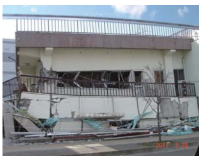
倒壊した店舗
